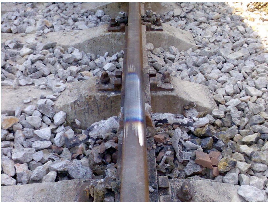
Slika 5.14. Izgled zavarene tračnice
