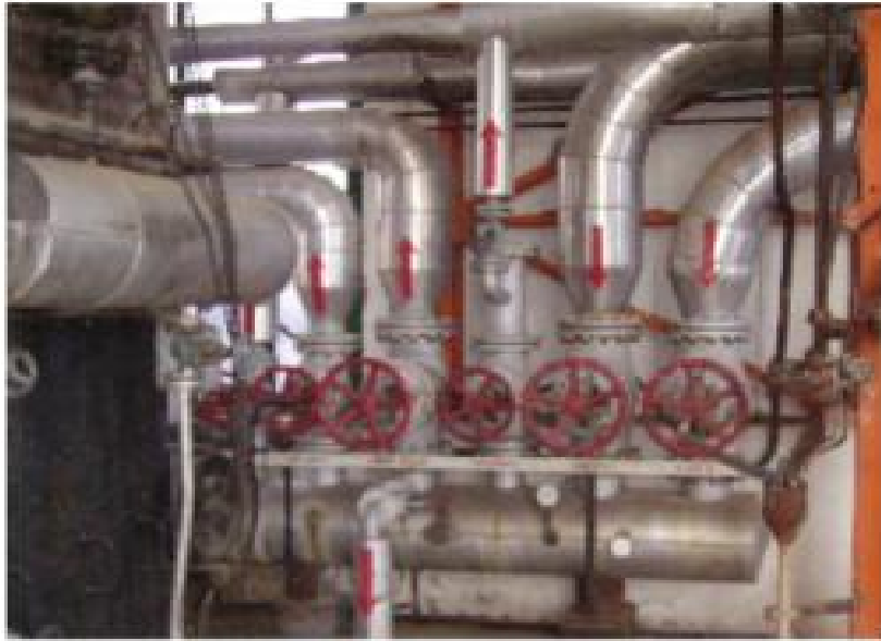
Slika 6.3. Pomoćni uređaji na kotlu
