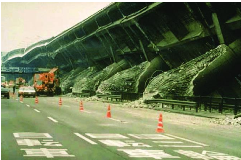
Slika 6.4. Prikaza oštećenih stupova vijadukta [20]
