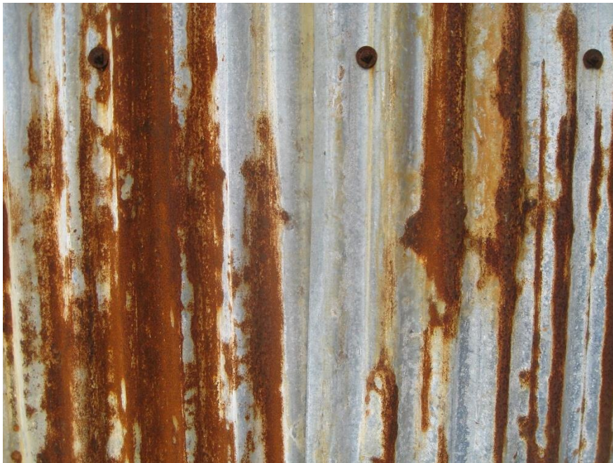
Slika 5.1. Pojava opće korozije
