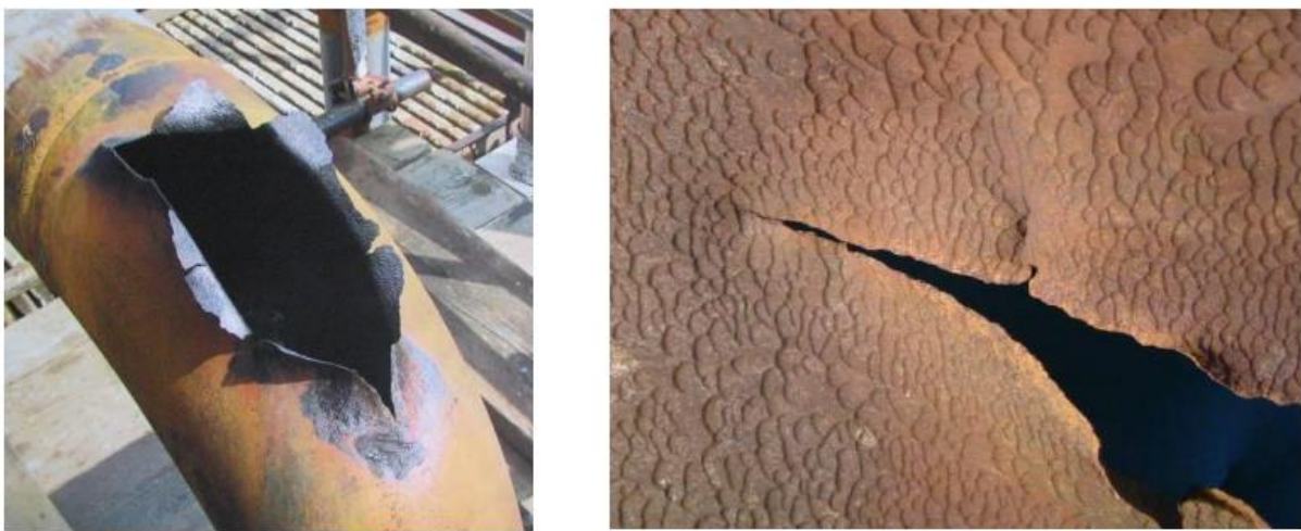
Slika 5.10. Posljedica erozijske korozije [16]
