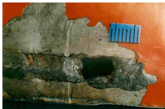
Slika 5.9. Stvarni prikaz oštećenja selektivnom korozijom [16]
