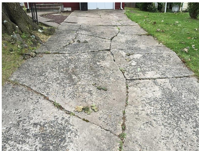
Slika 2.19. Korijenje stabla stvara štetu na prilazu stambenoj zgradi.
