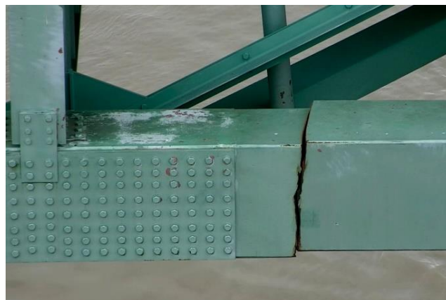
Slika 6.2. Pukotina čelične konstrukcije na mostu
