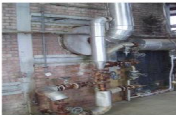
Slika 6.2. Pomoćni cjevovodi kotlovske postrojenja
