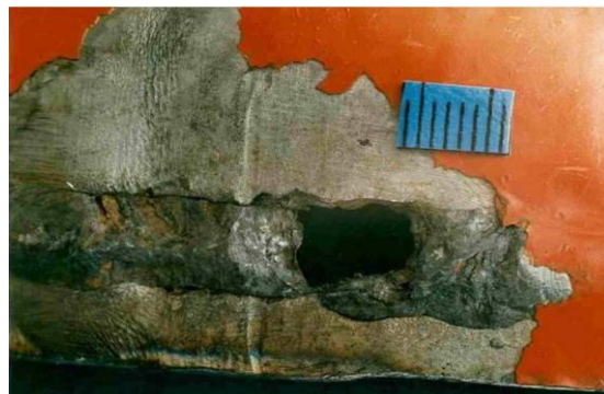
Slika 5.9. Stvarni prikaz oštećenja selektivnom korozijom [16]
