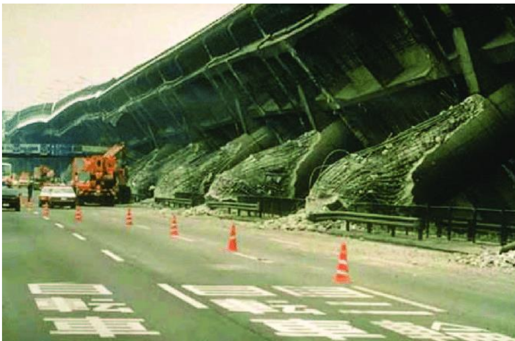
Slika 6.4. Prikaza oštećenih stupova vijadukta [20]
