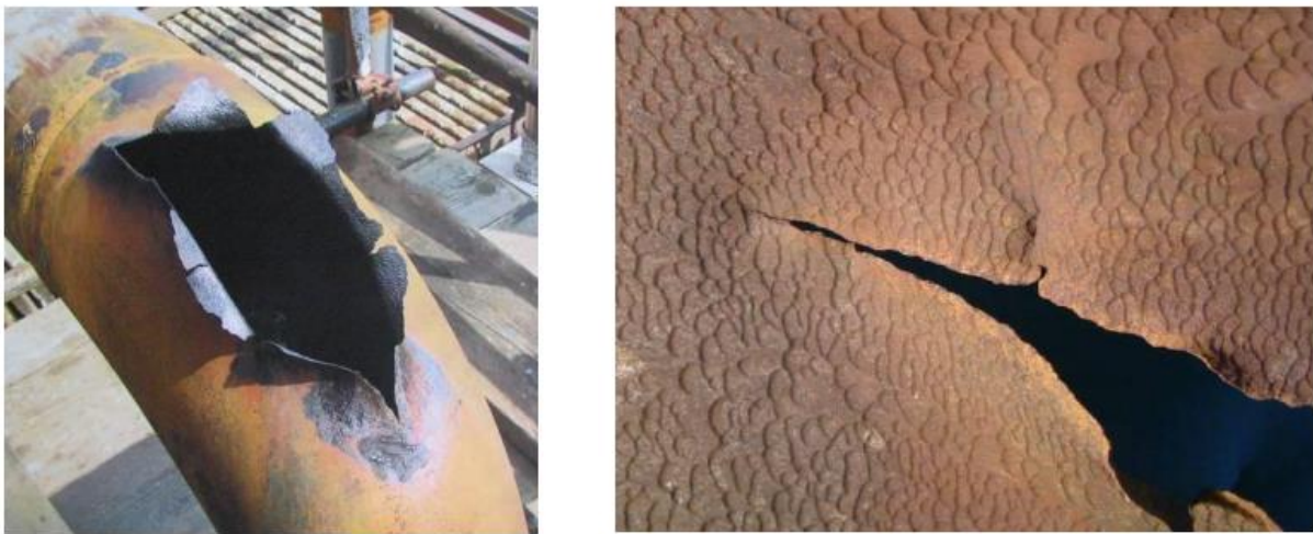
Slika 5.10. Posljedica erozijske korozije [16]
