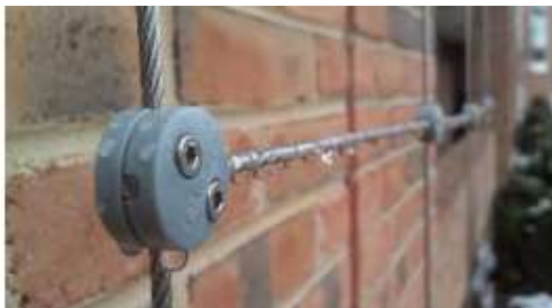
Slika 14. Sustavi šipki i kablova s rešetkama kabla koji su instalirani okomito
